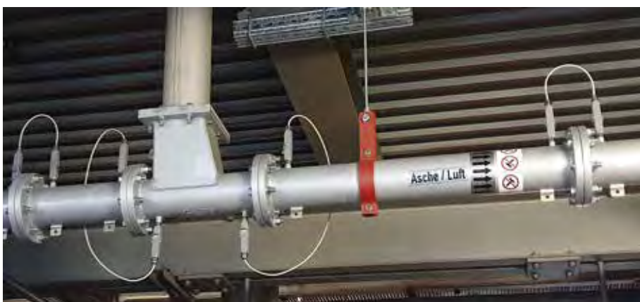
Injektoren im eingebauten Zustand: überwachte Leitungsteile – je 2 Steckverbindungen IP67 pro Rohrteil
