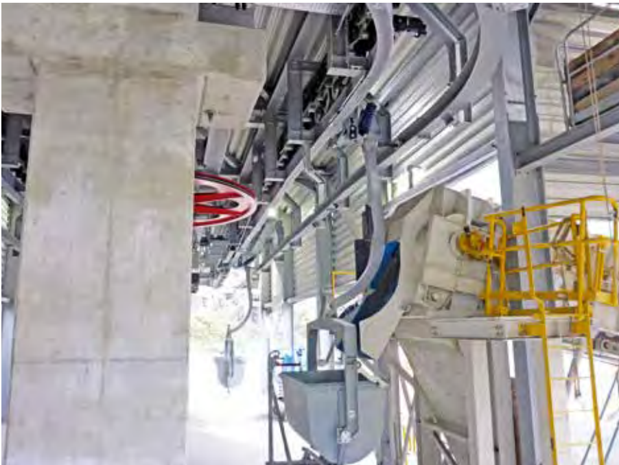
Um einen Betrieb des Zugseils mit konstanter Fahrgeschwindigkeit zu ermöglichen, werden die Materialkübel in den Stationen von der Zugseilschleife entkuppelt
