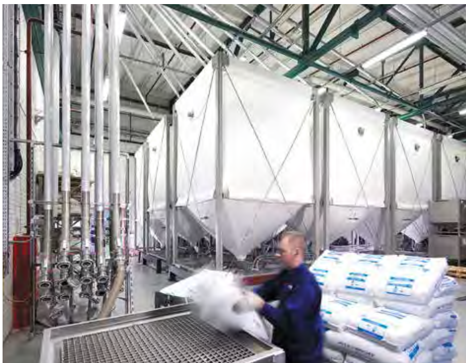
Flex-Siloanlage bei einem Verpackungshersteller
