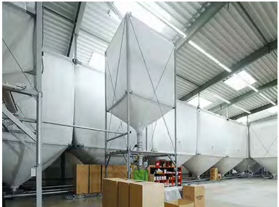
Flex-Siloanlage bei dem Sitzsackhersteller Sitting Bull
