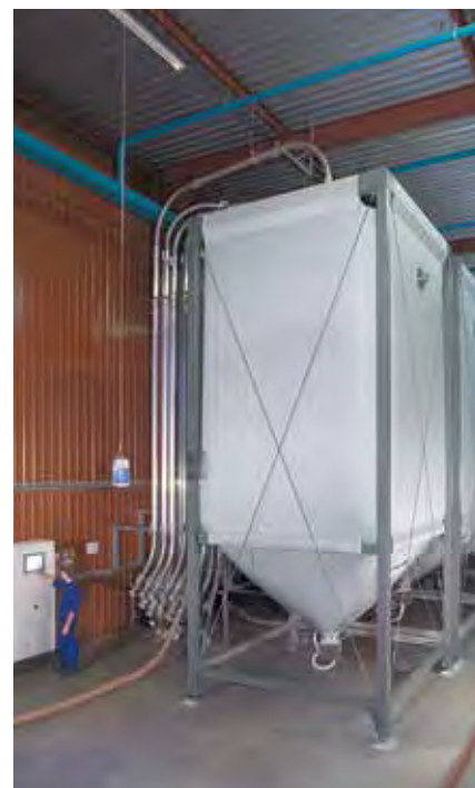
Flex-Silo-Anlage mit 7 Flex-Silos mit je 24 t
